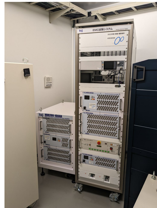
信号発生器、高周波電力測定器、高周波電力増幅器
