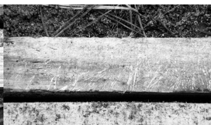
(腐朽菌の発生)
